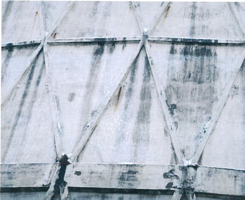
Slika 4: Na zunanji površini plašča hladilnega stolpa so vidni črni madeži – umazanija. Na več območjih se pojavlja odstopanje, odpadanje in razpokanje zaščitnega elastičnega premaza.
