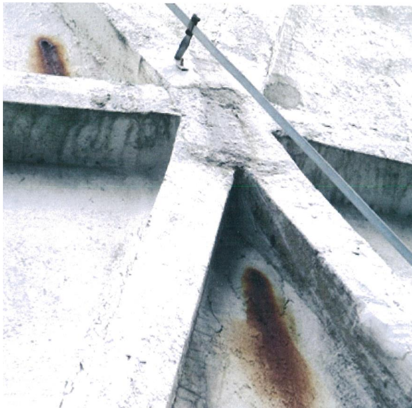
Slika 7: Predvsem na lokacijah sidranja polnilnih plošč v nosilne diagonalne in horizontalne elemente se na več lokacijah pojavljajo sledovi korozijskih produktov nad izrazito korodirano armaturo.
