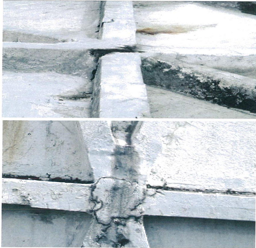
Slika 3: Lokalno se v stičiščih horizontalnih in diagonalnih nosilnih elementov pojavljajo razpoke in odstopanje in odpadanje vrhnjih plasti betona.
