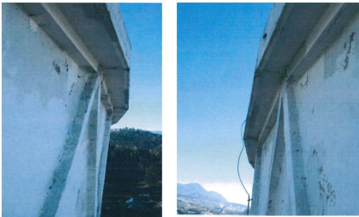
Slika 10: Na spodnji previsni površini krovnega venca se pojavljajo zasigane razpoke s kapniki.
