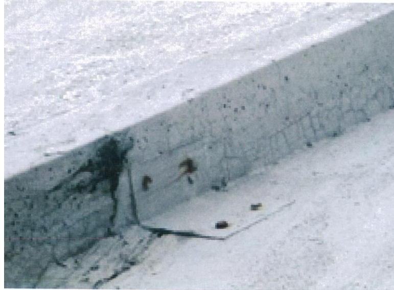
Slika 8: Sidrni vijaki, s katerimi je bilo izvedeno dodatno sidranje polnilnih plošč, so korodirani.
