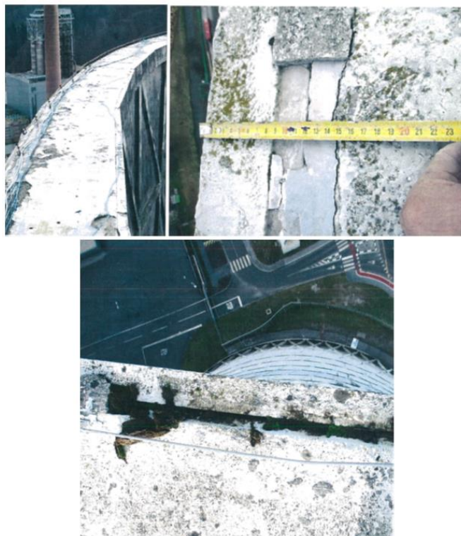
Slika 9: Na zgornji površini krovnega venca se pojavlja odstopanje in odpadanje vrhnjih plasti betona in maltnih preplastitev. Prisotno je razraščanje mahu in alg.
