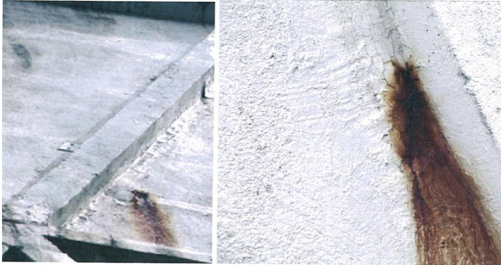
Slika 6: Na več lokacijah so v linijah stikov med AB polnili in diagonalnimi ter horizontalnimi nosilnimi elementi odprti delovni stiki in razpokane, odstopanje ter odpadanje betona oz. malte v linijah predmetnih stikov.
