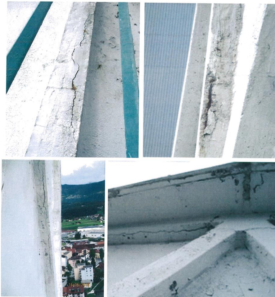
Slika 2: Na diagonalnih in horizontalnih nosilnih elementih se na več lokacijah pojavlja razpokanje in odstopanje ter odpadanje vrhnjih plasti betona nad korodirano armaturo.
